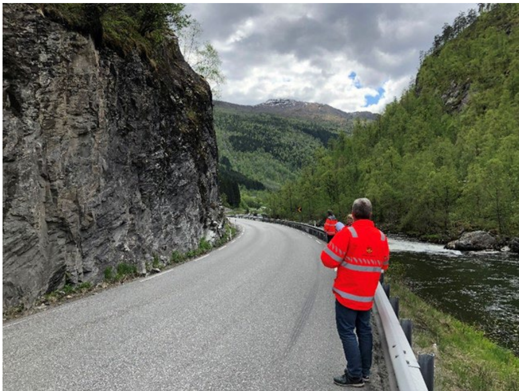
Figur 15 Dagens vegskjering ved Kvarmakløvet. Her må ein sprengje ut 2-3 hyller i fjellet
