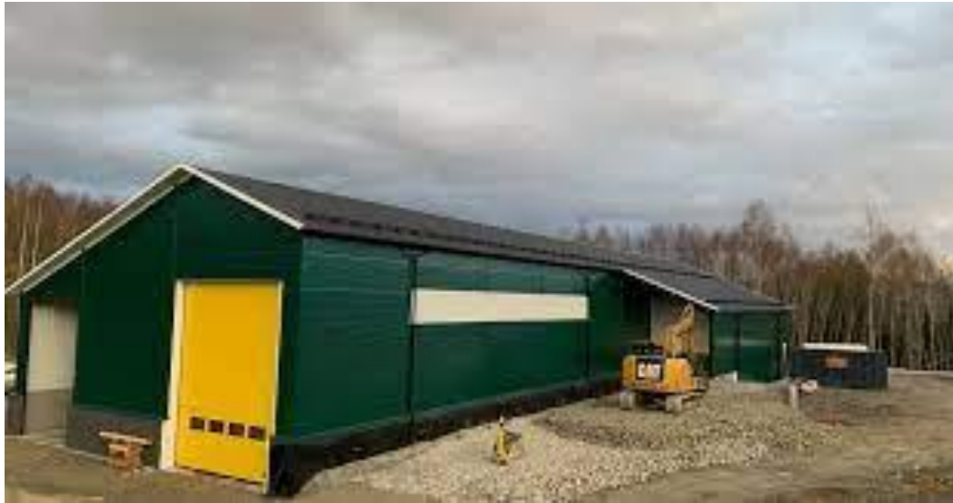
Figur 17: Biokullanlegg på Rudshøgda. Kilde: Nortura.
