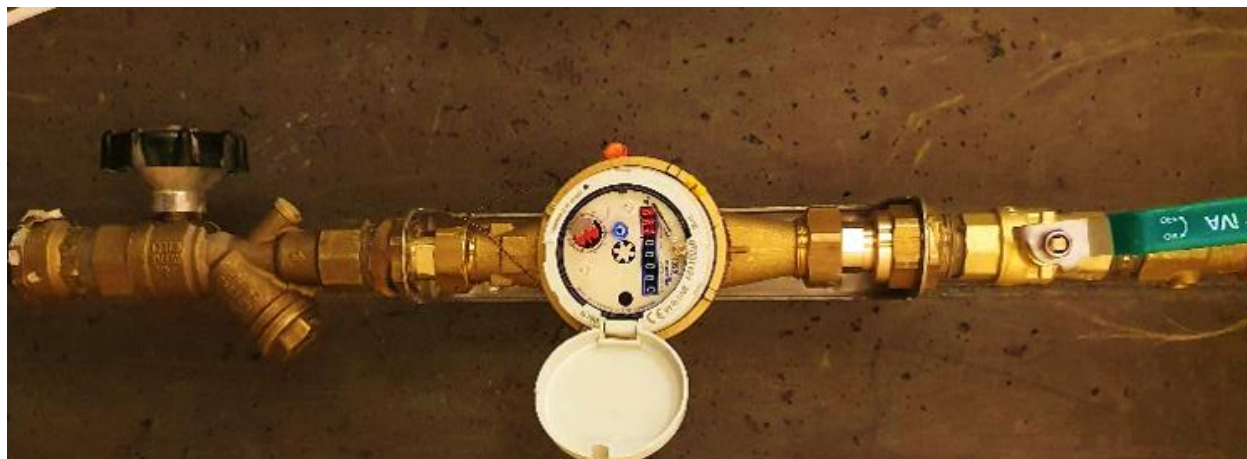
Figur 1 Vassmålarinstallasjon, med tirrpepventil, sensus 620 vassmålar og kuleventil.
